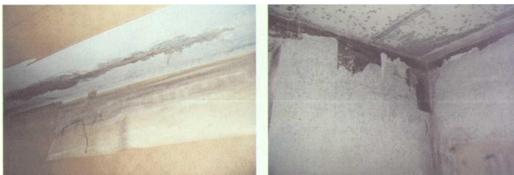
Фото 7-8 Дефекты плит перекрытия первого и второго
