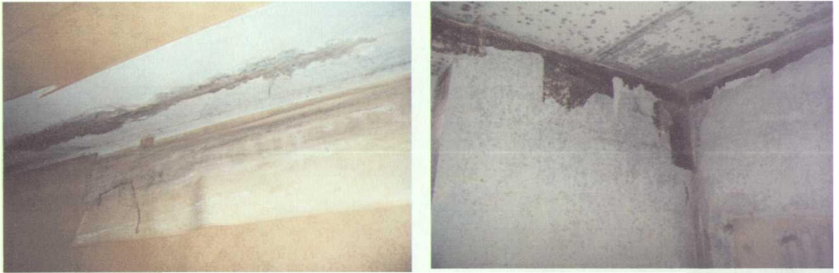
Фото 7-8 Дефекты плит перекрытия первого и второго
