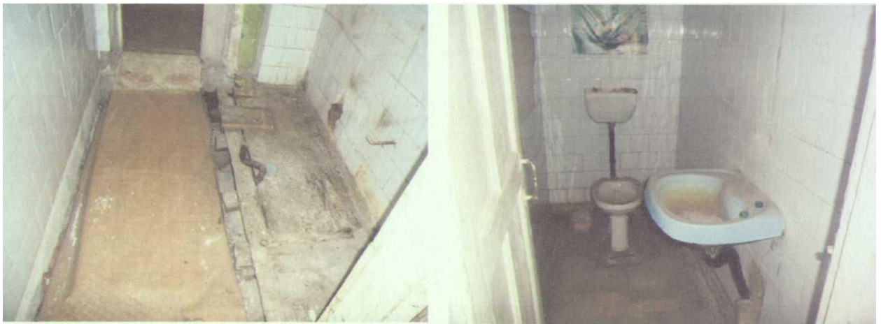
Фото 21-22 Состояние покрытия пола, изношенность санитарных приборов
